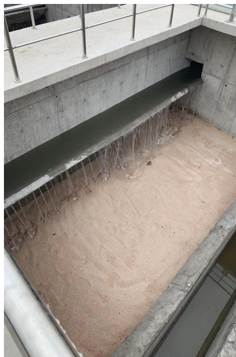
除铁除锰滤池
