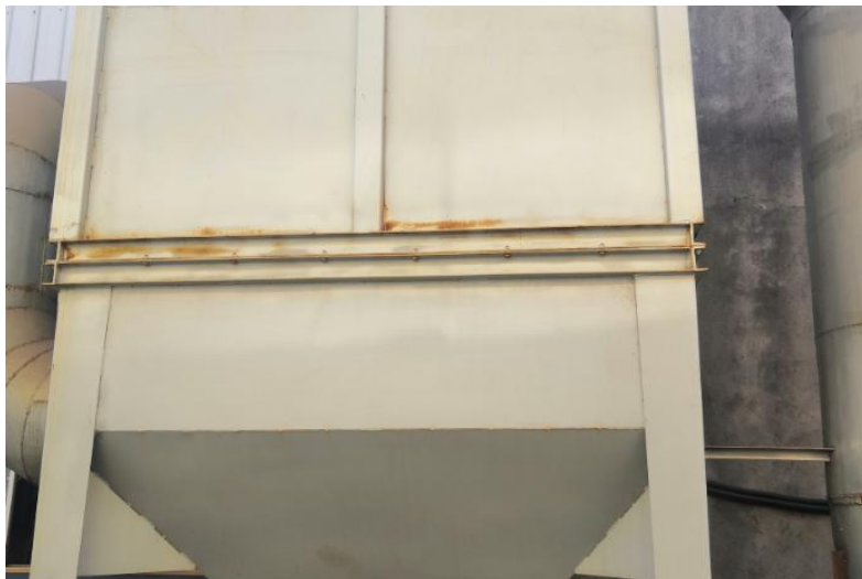
布袋除尘器装置
