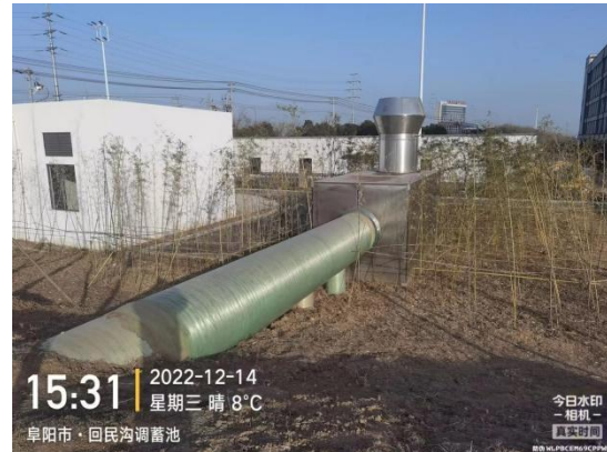
回民沟调蓄站除臭系统
