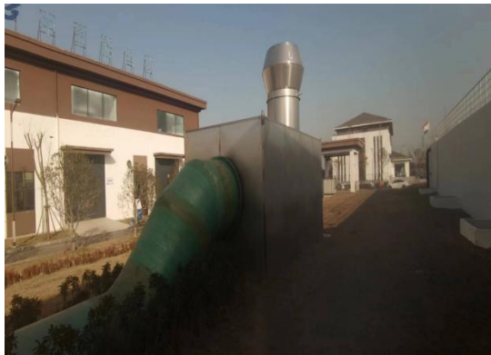
东城河调蓄站除臭系统
