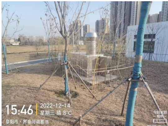
界亳河调蓄站除臭系统
